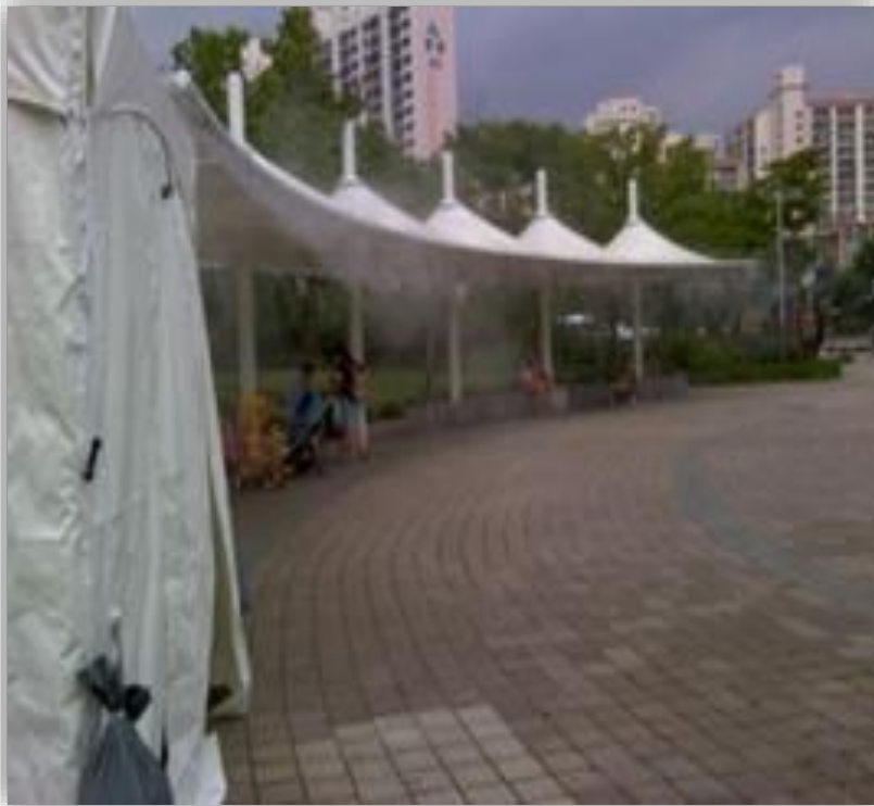
쿨링포그 설치 사진
